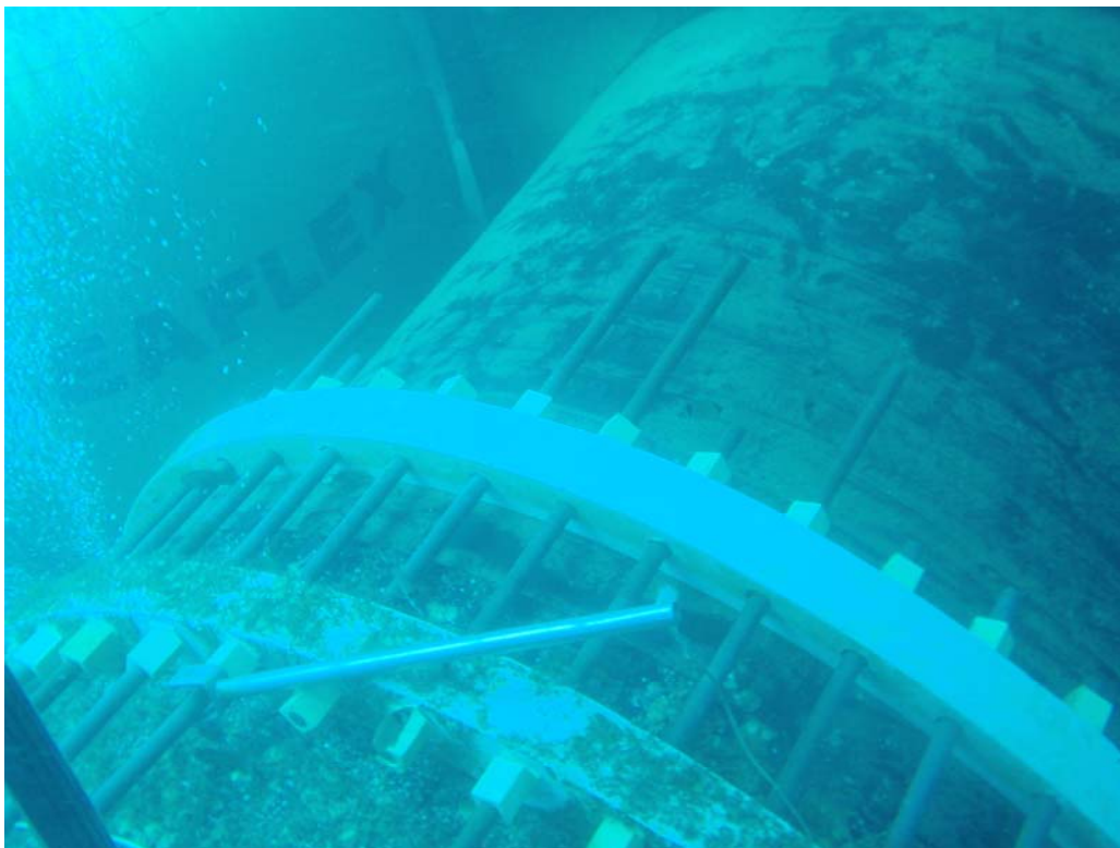
Unión embridada entre dos tramos de tubería de PE. Tubería de 1.800 mm de diámetro interior.
