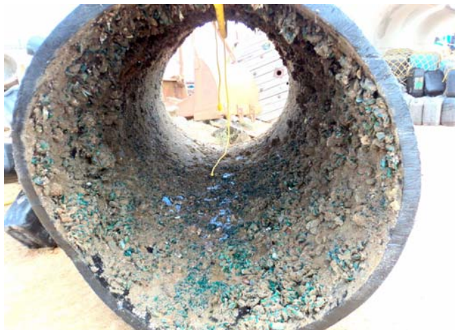
La adherencia de seres vivos en el interior de conducciones submarinas es un gran problema con cualquier material
