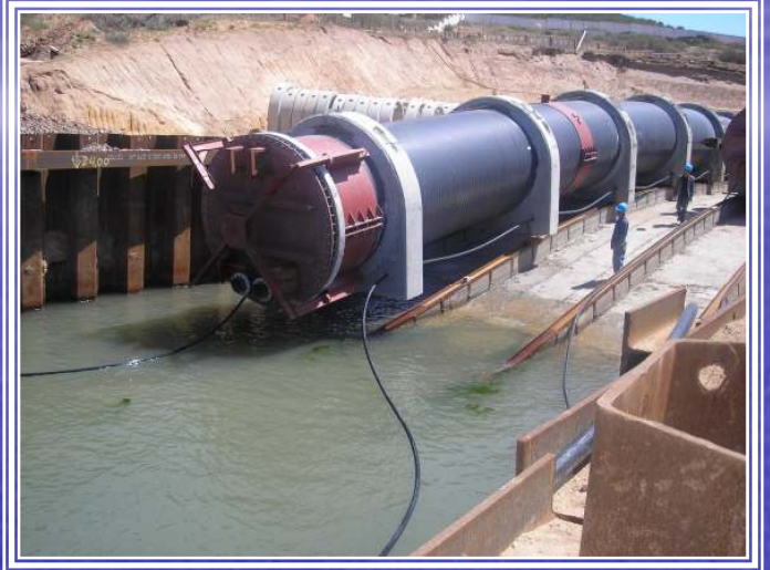
Rampa de lanzamiento de la planta desaladora de Beni-Saf (Argelia) Di=2.400 mm
